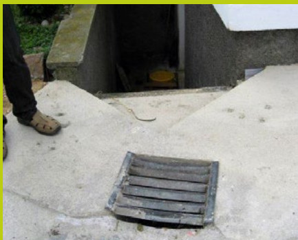
Bild 1 | Bei Überlast wird der Keller überflutet.
