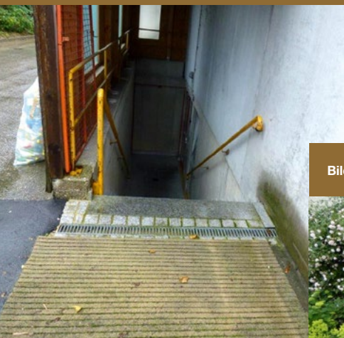
Bild 6 | Ungeschützter Zugang zum Keller ...
