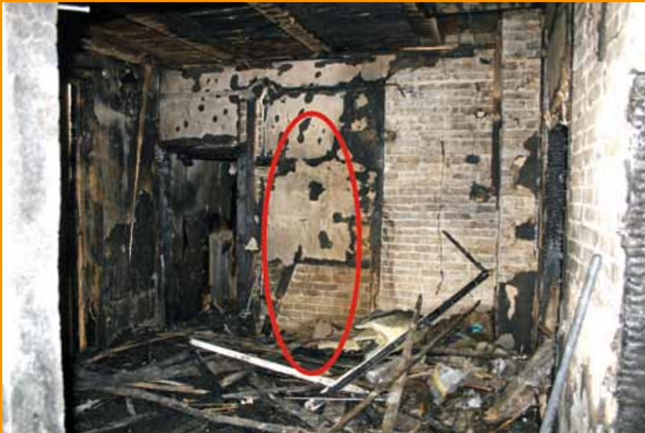
Das Wohnzimmer aus dem beschriebenen Schadenfall; der Standort des Weihnachtsbaumes ist markiert.
