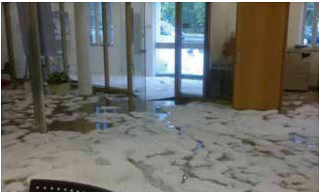
Starkregen mit Hagel drückte in diese Geschäftsräume.
