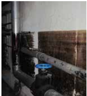
Ölschaden nach dem Hochwasser
